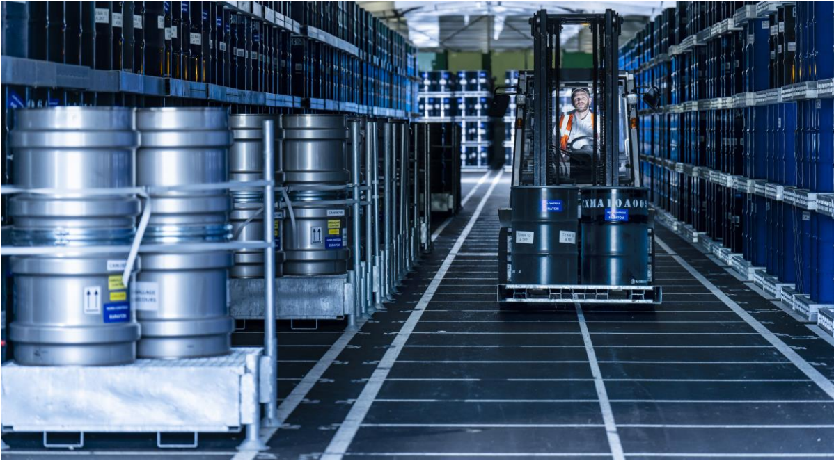
Figure 3-1 : parc d'entreposage de fûts d' U_3O_8 (URT) sur le site Orano du Tricastin
