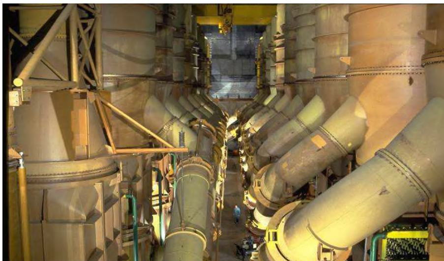
Figure 5 : Vue d'ensemble de diffuseurs de l'usine Georges-Besse
